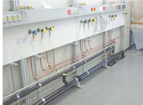
Energiezellen mit Elektrokanal, Armaturen und Sanitärverrohrung
