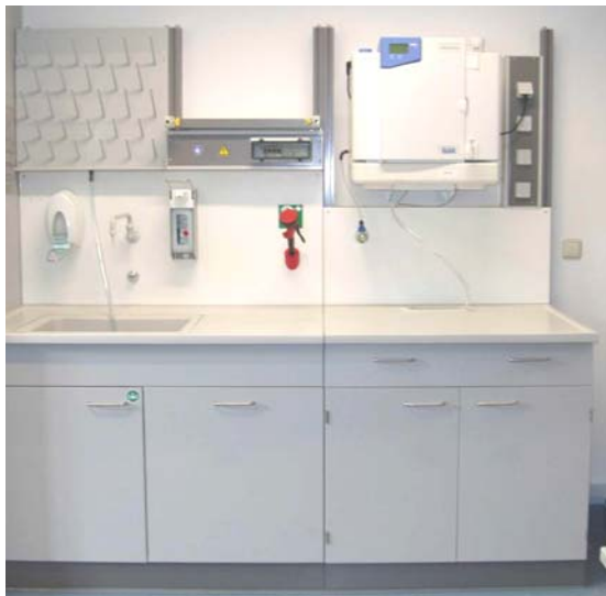
Spülarbeitsplatz mit berührungsloser Armatur, zellenbefestigter Augendusche und Reinstwasseranlage
