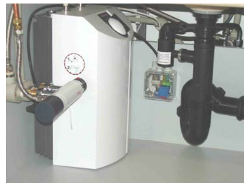
Druckfester Warmwasserbereiter mit Sicherheitsarmatur im Installationsunterbau
