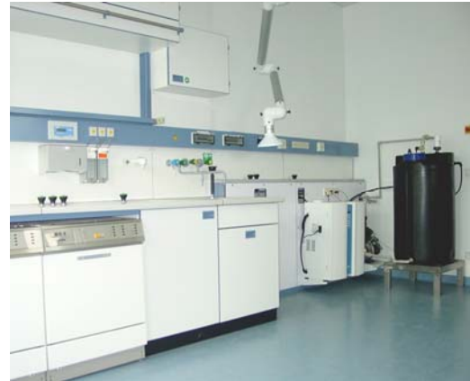
Nassarbeitsplatz mit Reinigungs- und Desinfektionsautomat, zentraler Reinstwasseranlage, Punktabsaugung
